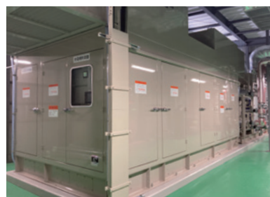
Máy phát điện tại chỗ
