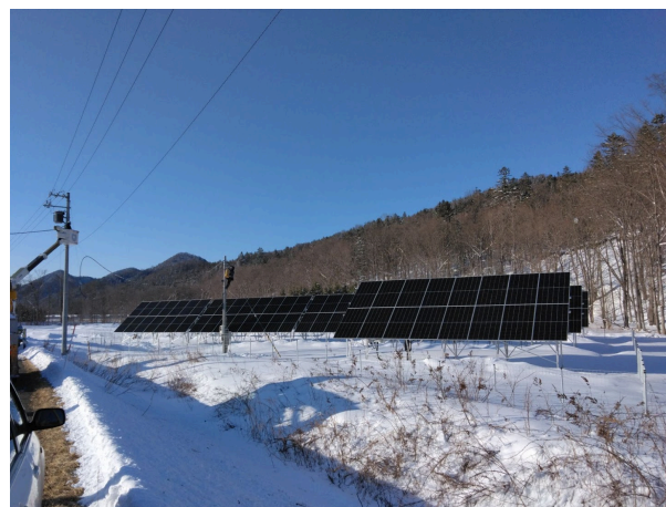
コープさっぽろ北見市留辺薬町厚和第2発電所
